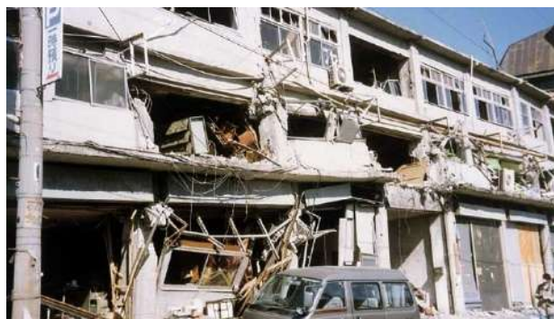
(出典：財団法人消防科学総合センター災害写真データベース)
